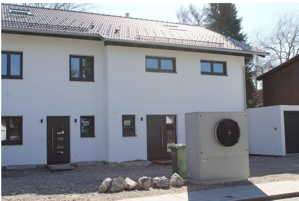
Abbildung 29: Luftwärmepumpe in Außenaufstellung
