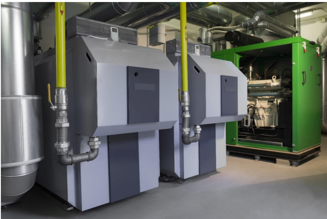
Abbildung 31: Blockheizkraftwerk (BHKW) in einem Heizungsraum
