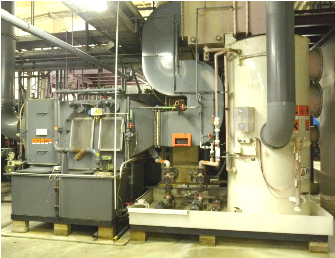
Abbildung 3: Verdunstungsanlage einer Anlage zum dekorativen Verchromen
