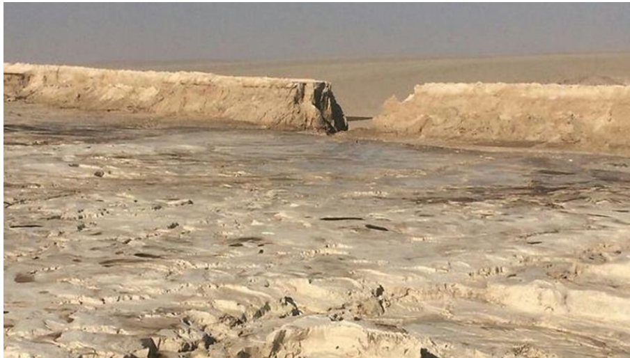
Abbildung 13-12: Dambruch in der Rotem Gipshalde vom 30.06.2017
