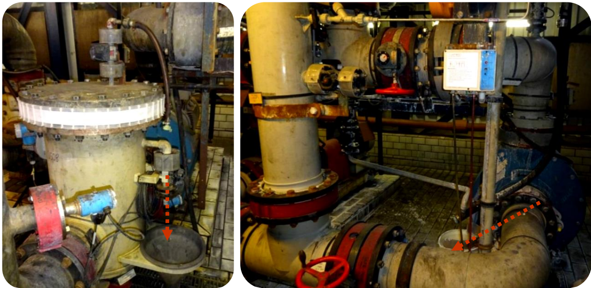
Abbildung 29: Probenahme Quenche (links), Probenahme der Füllkörperstufe 1 (rechts).
