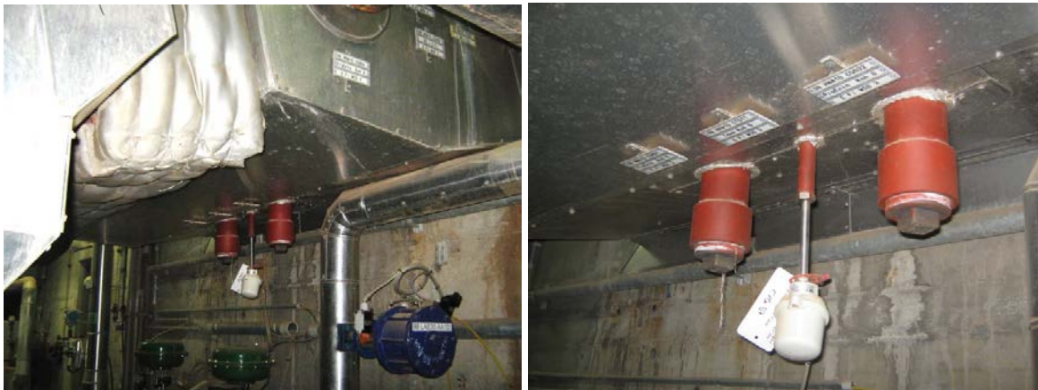
Messstelle Abgasbeprobung: Messstelle 1 nach Kessel
