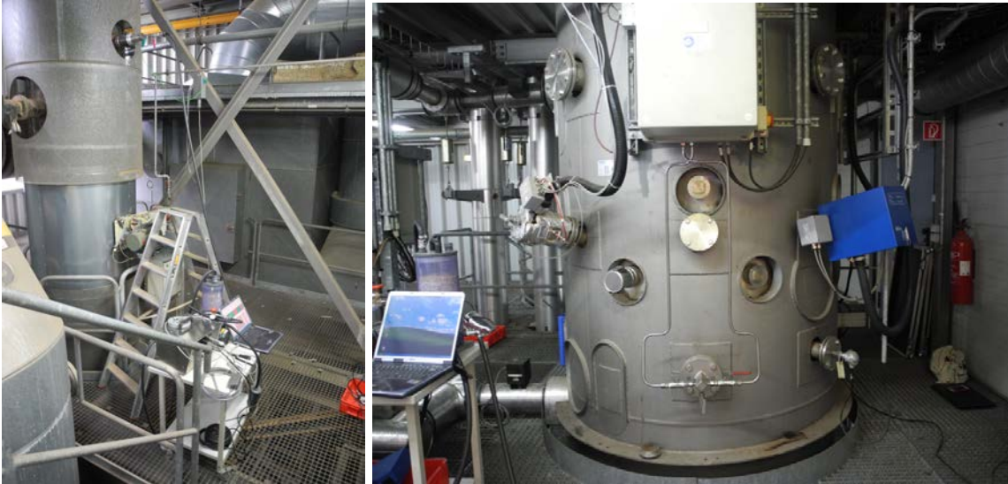
Messstellen Abgasbepröbung: Messstelle 2 nach E-Filter (links); Messstelle 3 vor Kamin (rechts).
