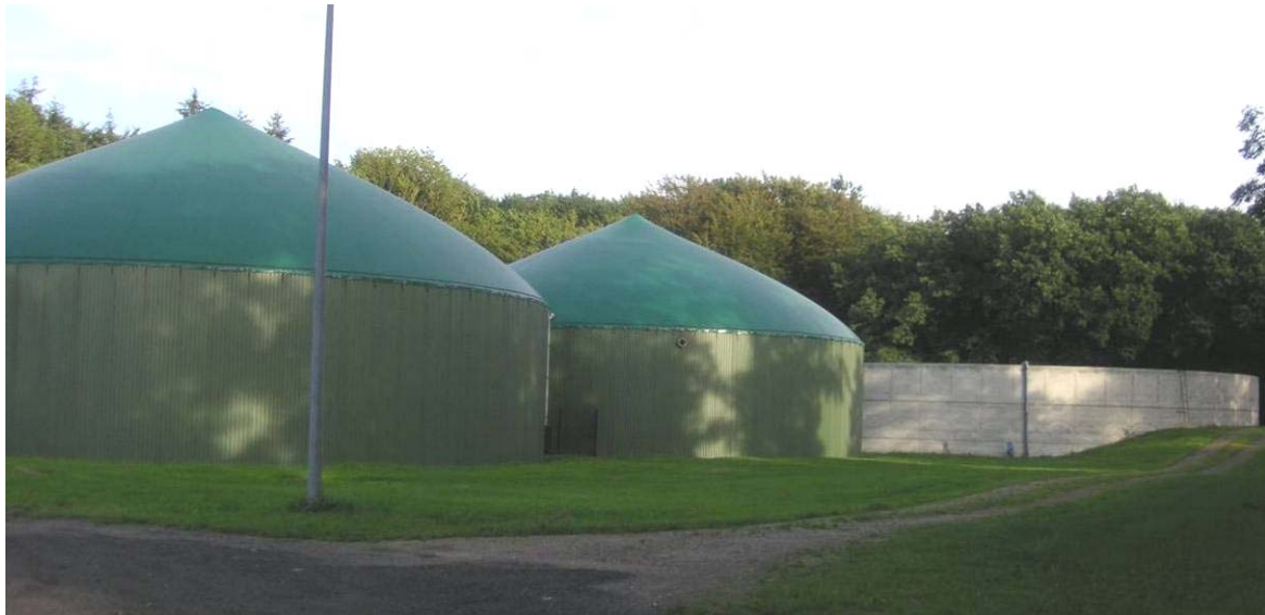
Abbildung 13: Biogasanlage über 500 kW
