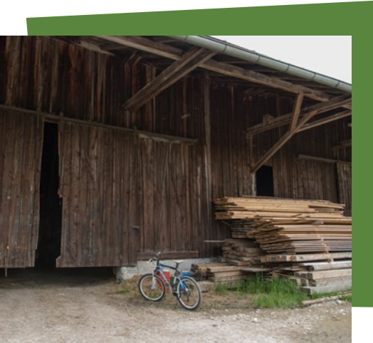
Deutlich sichtbare Sackung des Moorbodens an einer Scheune im Moor
