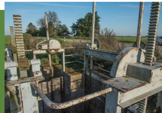
Altes Stauwerk mit sichtbarem Instandsetzungsbedarf in einem Niedermoor
